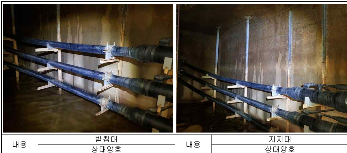
【사진 8.36】 부속 및 부대설비 현황
