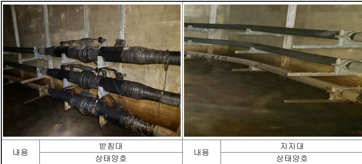
【사진 8.8】 부속 및 부대설비 현황
