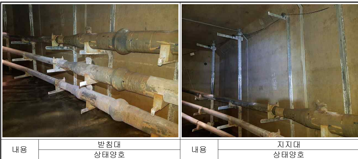
【사진 8.40】 부속 및 부대설비 현황
