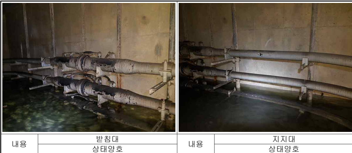
【사진 8.4】 부속 및 부대설비 현황
